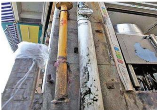
图1 室外燃气管腐蚀脱漆生锈
