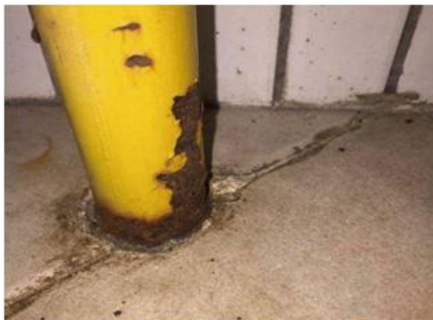
图2 室内穿楼板燃气管腐蚀生锈
