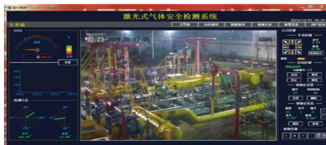
图26：激光式气体泄漏检测系统
