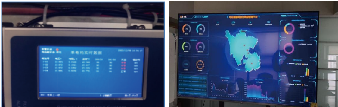
图27：搭建UPS蓄电池远程智能管理系统
