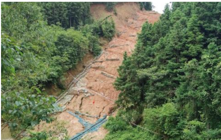
图 4 管道坡面水毁现场状况
