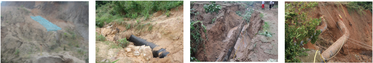
(a) 冲沟及管道浅埋 (b) 露管 (c) 管道悬空 (d) 管道冲击弯曲
